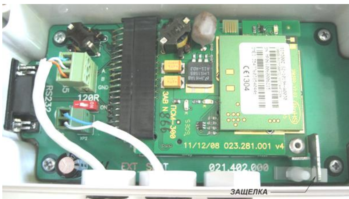
Рисунок 17.9. Фиксация ПР теплосчетчика МКТС в УППР.
